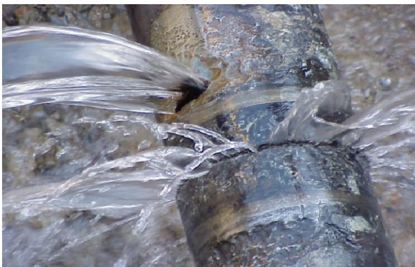
Daños en redes de agua potable
