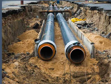
Riesgo de Fallas en Tuberías
