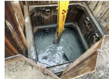
Foto 2.1: Fluidez de las arcillas blandas en un pozo de recepción.
