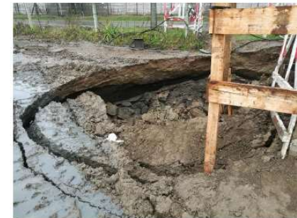
Foto 2.2: Rotura del suelo en el orificio de recepción de la tunelera y formación del socavón en la superficie
