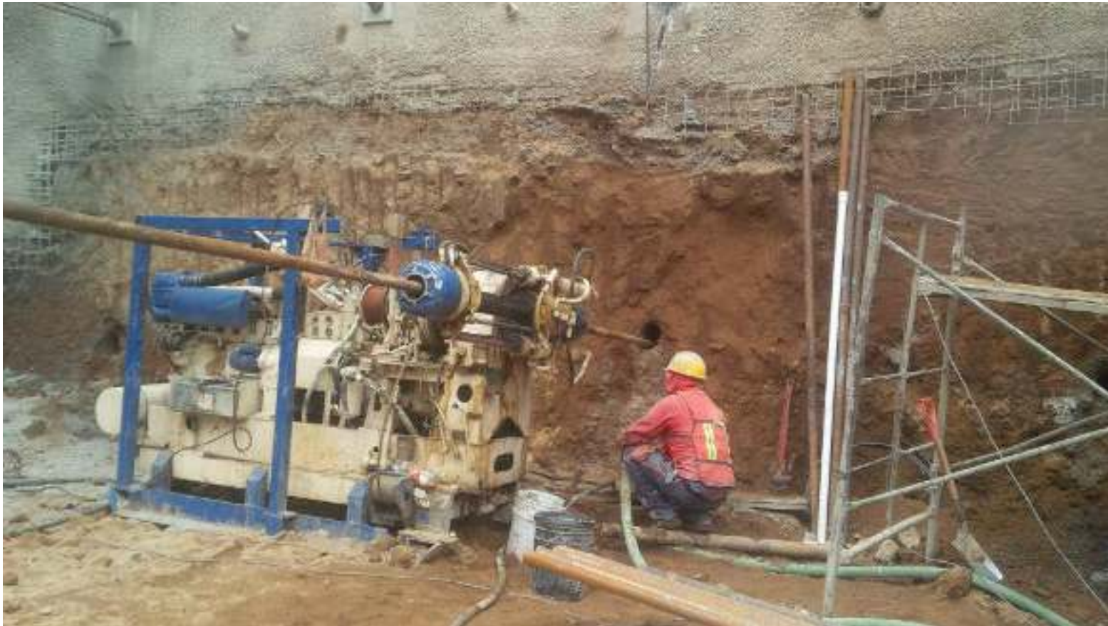
DF. MEXICO – ESTACIONAMIENTOS SUBTERRANEOS
