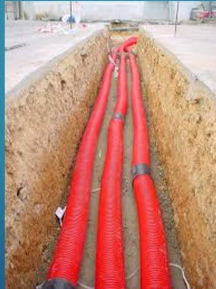
Daños en redes eléctricas
