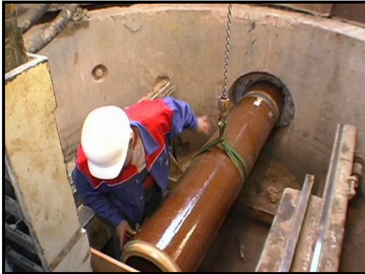
Foto 21 Instalación de la tubería nueva usando el método de Auger Boring Bohrtec 2011
