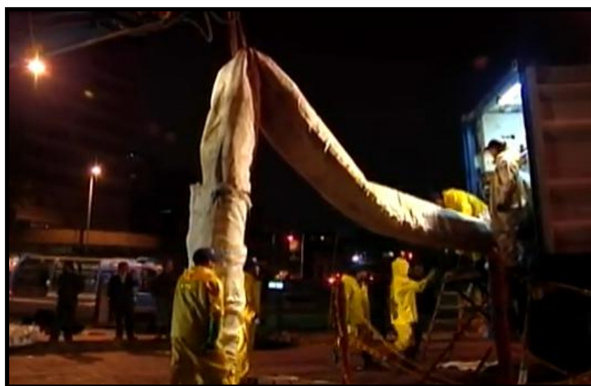
Foto 28 Inserción de la línea textil dentro del pozo y tubería a rehabilitar Pavco 2011
