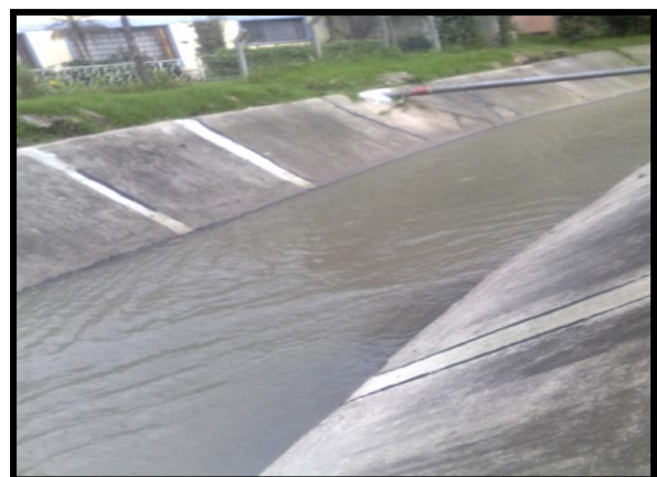
Foto 84 Canal que se rebosa con facilidad
