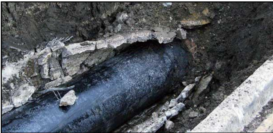
Foto 43 Proceso simultaneo de rotura e instalación de una tubería a través del método de Pipe Bursting Hammerhead, 2011
