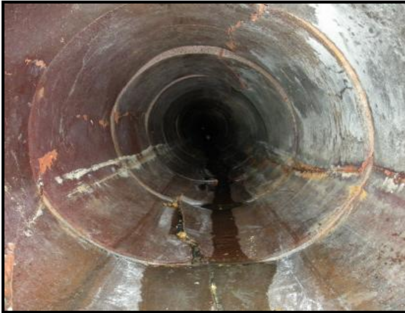
Foto 100 Estado inicial de la tubería de la CII 106 antes de intervenir (Pavco, 2011)
