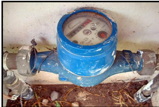
Foto 105 Medidor de agua potable EAAB 2011
