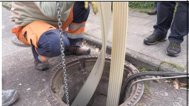
No hay que romper el pozo de registro
