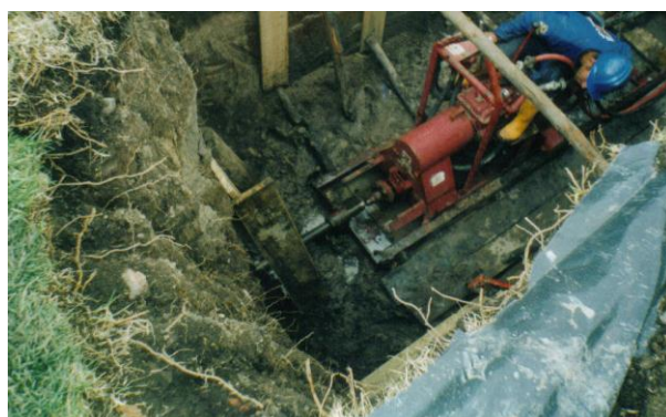
Figura 4: Operar equipo de perforación horizontal dirigida de acuerdo con manuales técnicos y normas de seguridad
