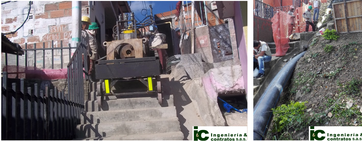
Figura 5. Izquierda: transporte de unidad de halado por escalas. Derecha: halado de tubería polietileno con equipo de pipe bursting sin excavar pozo de lanzado (la máquina se ubica arriba).
