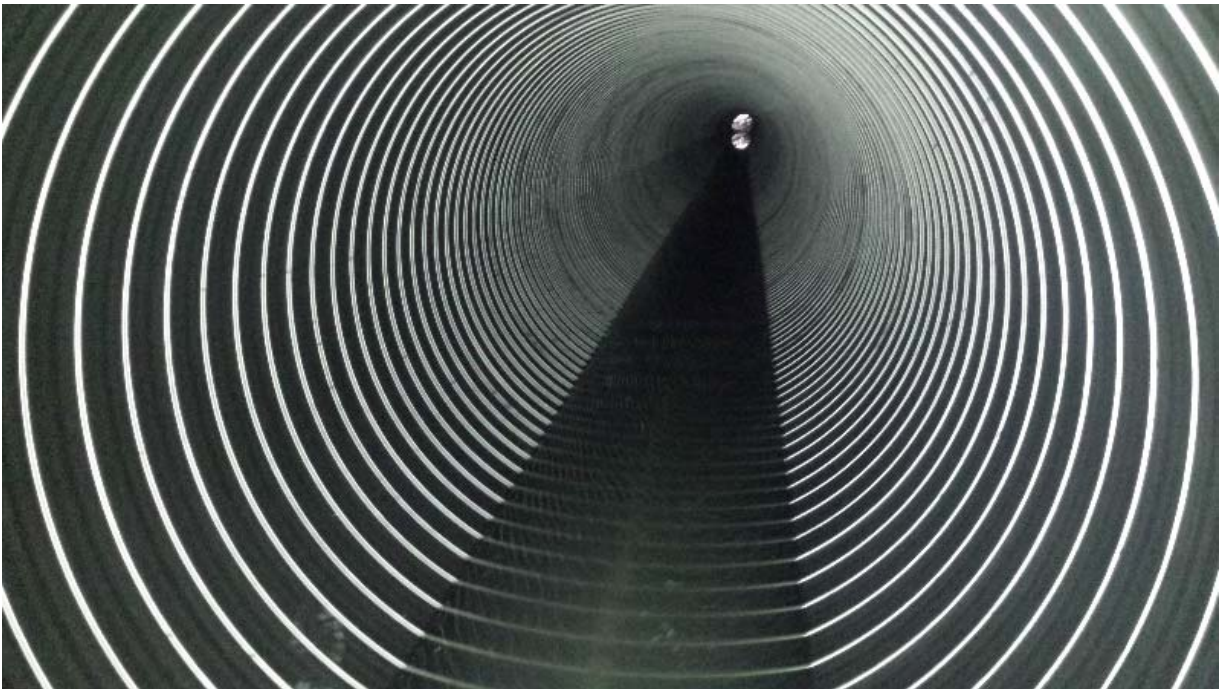
Figura 1: Vista de perfil instalado
