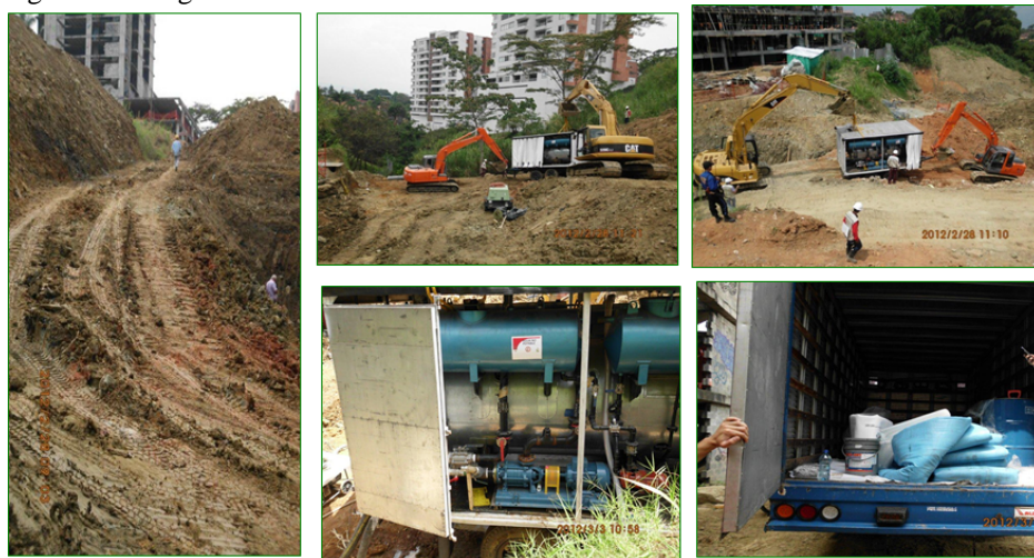
Figura 9: Aspectos generales del transporte de los equipos hasta el punto de inserción
