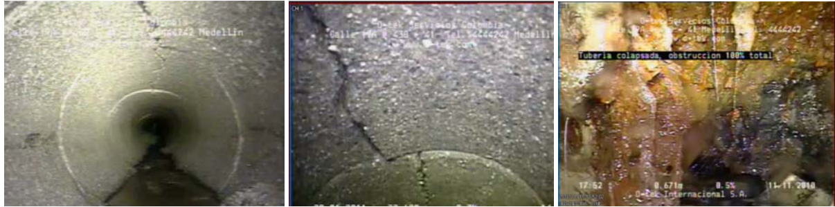
Figura 5: Imágenes de la tubería, se observar fracturas, colapsos e infiltraciones
