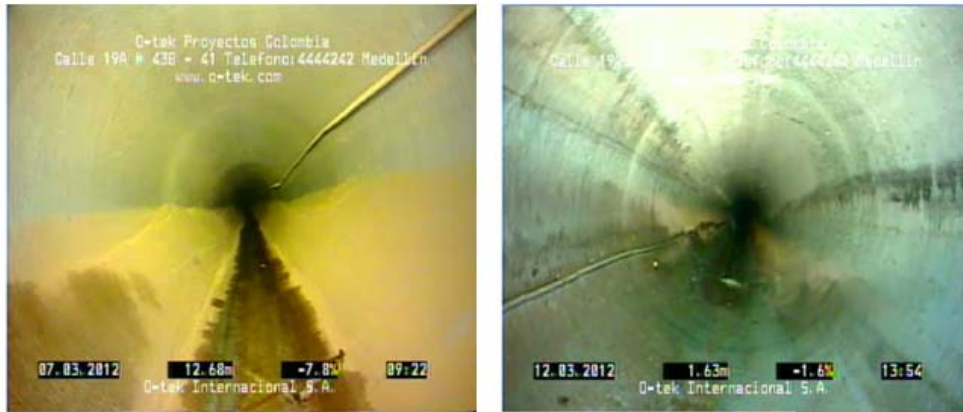
Figura 11: Aspecto del colector rehabilitado, se observa la formación de pliegues.
