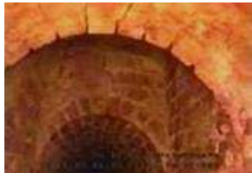
Daño de Superficies
