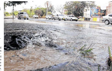
La semana pasada el robo de un contador generó un daño en la red de acueducto en la Calle 5 con Carrera 14. El caso fue atendido en 24 horas debido al respaldamiento de órdenes.
