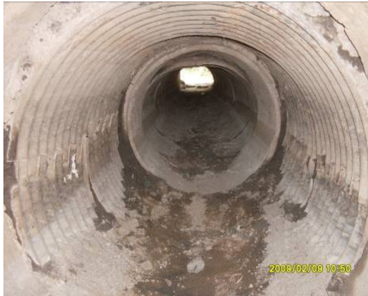
Tubería en mal estado a antes de rehabilitar
